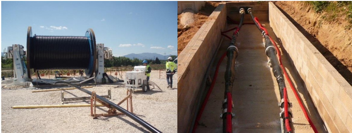
Touret de câbles et chambre de jonction
