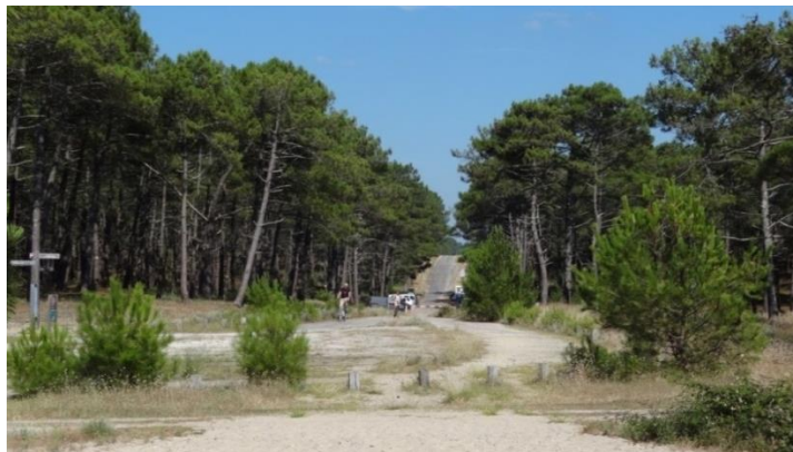
La zone d'implantation du chantier pour le passage en sous-œuvre* sous la dune
