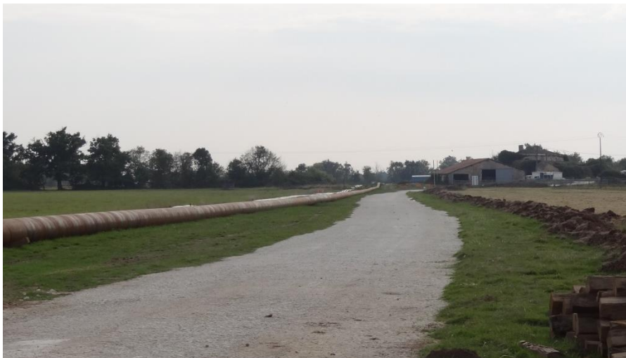
Tubes assemblés en bordure de la piste d'accès sur le chantier du sous-œuvre* de la ligne 225 000 volts Bruges - Marquis (sept.2014)
