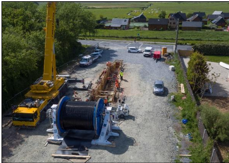
Chambre de jonction d'atterrage – Source : RTE
