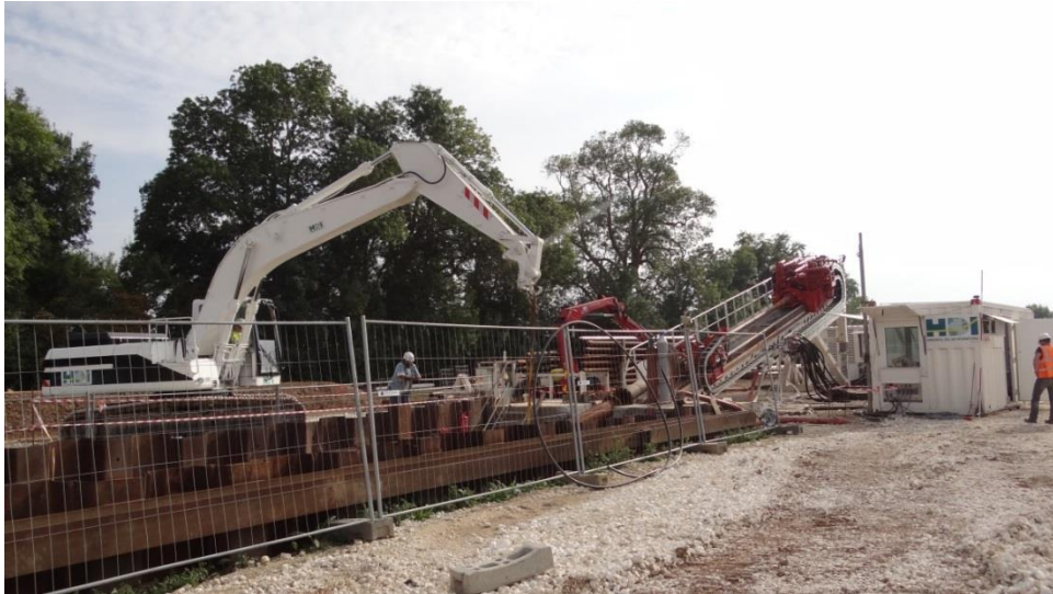
Chantier du forage dirigé sous la Garonne pour la ligne 225 000 volts Bruges - Marquis (sept.2014)
