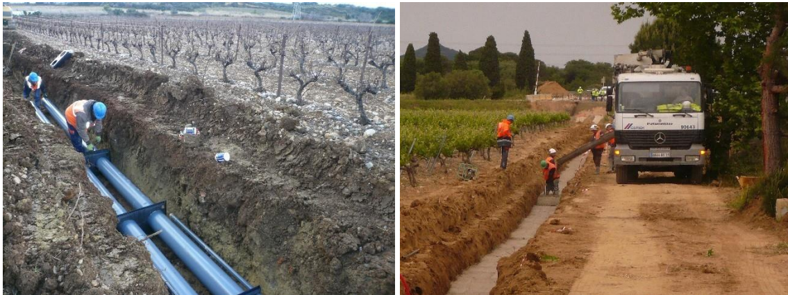
Photos de la pose du génie civil d'une liaison souterraine en fourreaux PVC*(liaison Baixas – Santa Llogaia)
